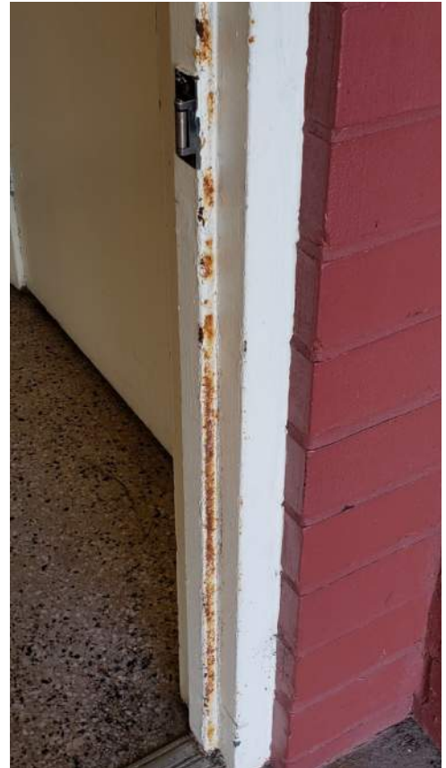
Deteriorating Door Jambs
