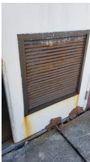
Rusting HM Door Louver
